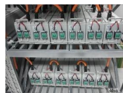
储能电站及通讯机房用
